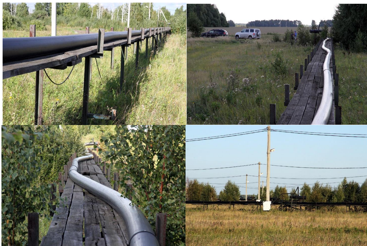
Рис. 13. Внешний вид системы трубопроводов технологических растворов
